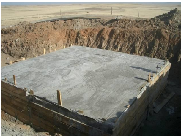
Рисунок 2. Железобетонный колпак 5 \times 5 \times 5 \text{ м}^3 над одной из скважин
