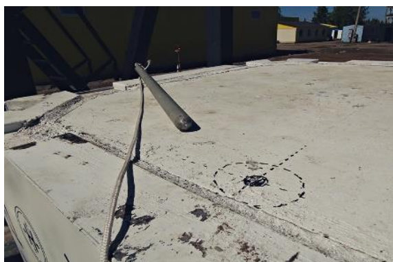
д) Испытание на глубину разрушения
