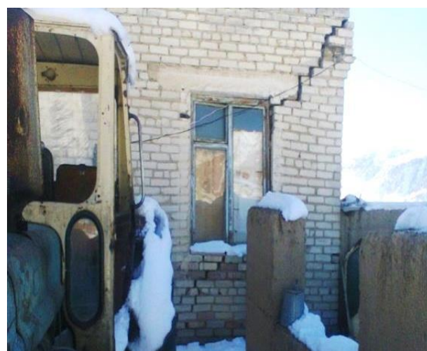
Фото 1. Откол части дома по образовавшимся трещинам ( N 42^{\circ}05'01,5'' ; E 77^{\circ}14'21,0'' ; alt. 2452 м; ул. Достук 1)
