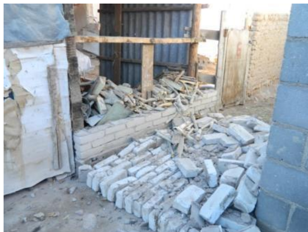
Фото 3. Обрушение внешней стены у хозяйственной пристройки к дому
