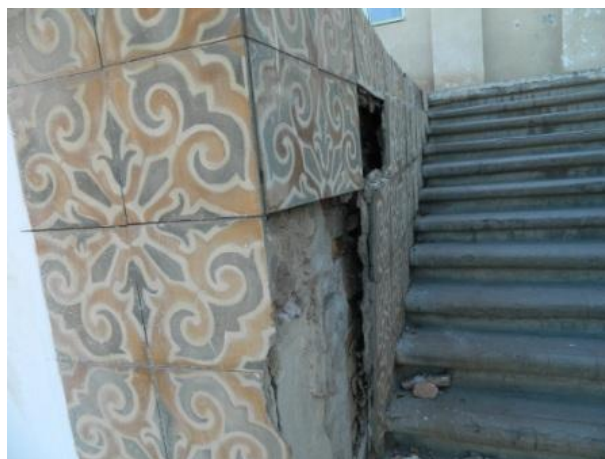
Фото 4. Падение облицовочной плитки
