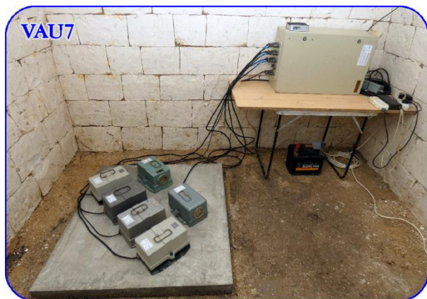
Рисунок 3. Пример установки сейсмической станции
